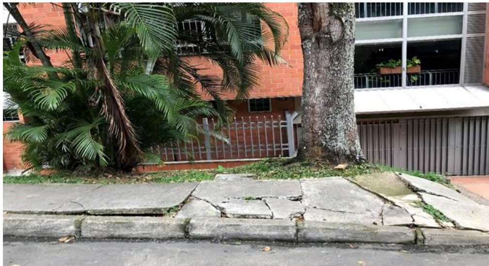
Fotografía 2. Falta adecuación o reconstrucción de los contenedores de raíces.
