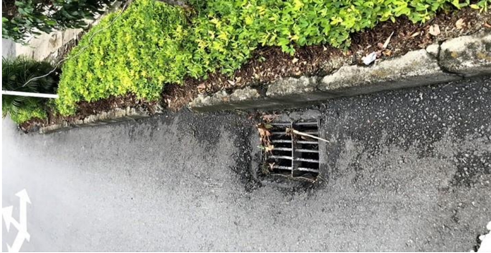
Fotografía 1. Intervención solamente de pavimento, sin que se realicen cordones.
